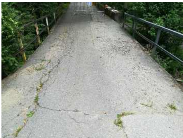
Foto 1: Danneggiamento asfalto esistente
