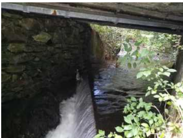
Foto 5: Erosione spalla ponte
