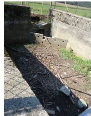
Foto E3: Camera di raccolta dopo il sottopassaggio della strada cantonale, con pareti verticali, una trappola per animali e anfibi.
