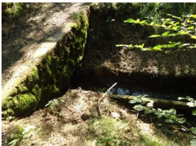
Foto F3: Nel bosco, le acque escono dal canale interrato...
