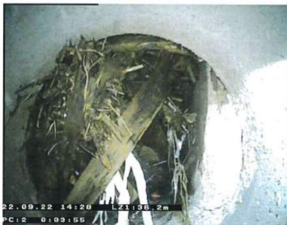
Figura 11 – Intasamento riscontrato alla progressiva +150.
