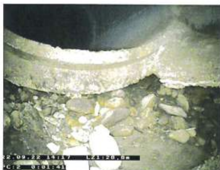
Figura 10 – dettaglio della rottura di fondo alla progressiva +128.
