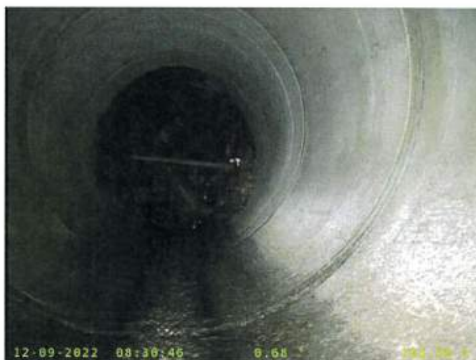
Figura 7 – Vista dell'intasamento presente alla progressiva 110.
