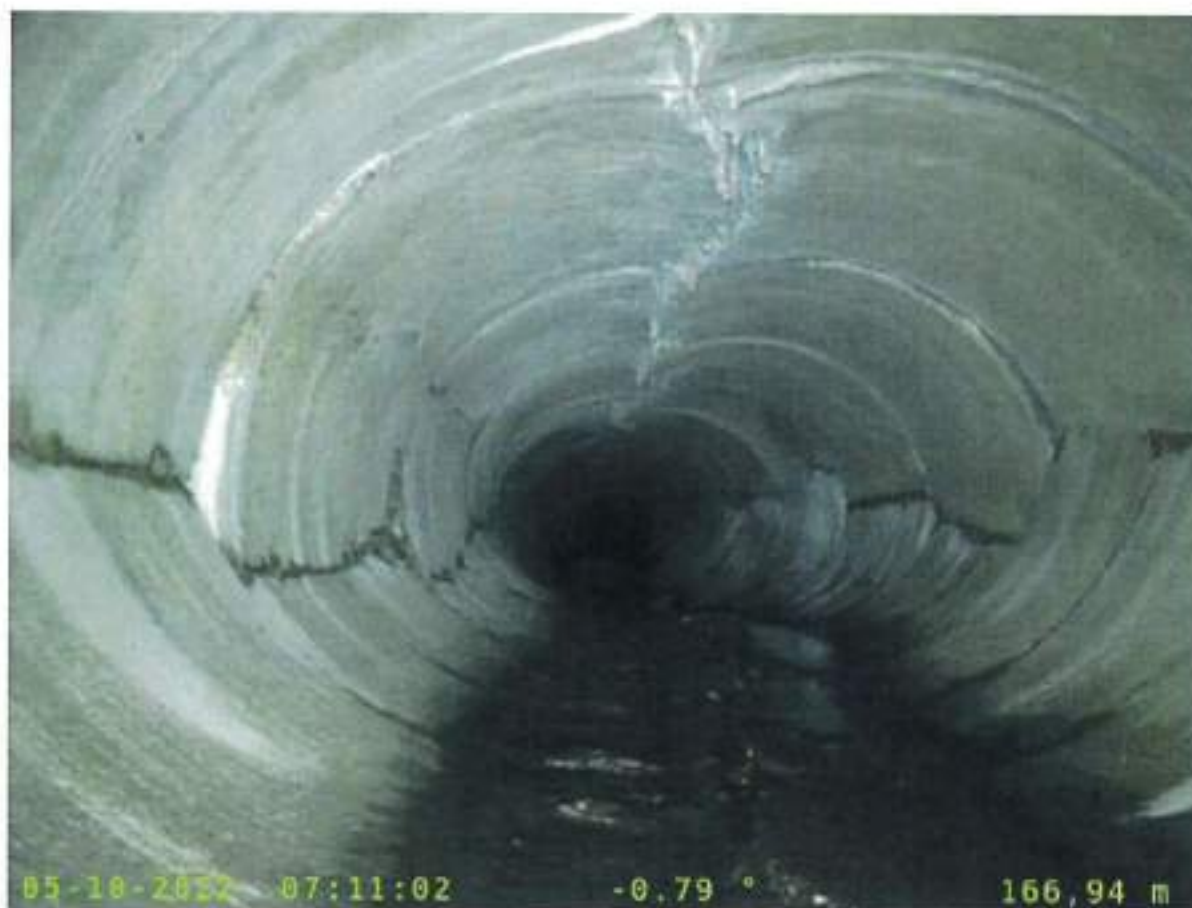
Figura 20 – Vista dello stato del canale interrato.
