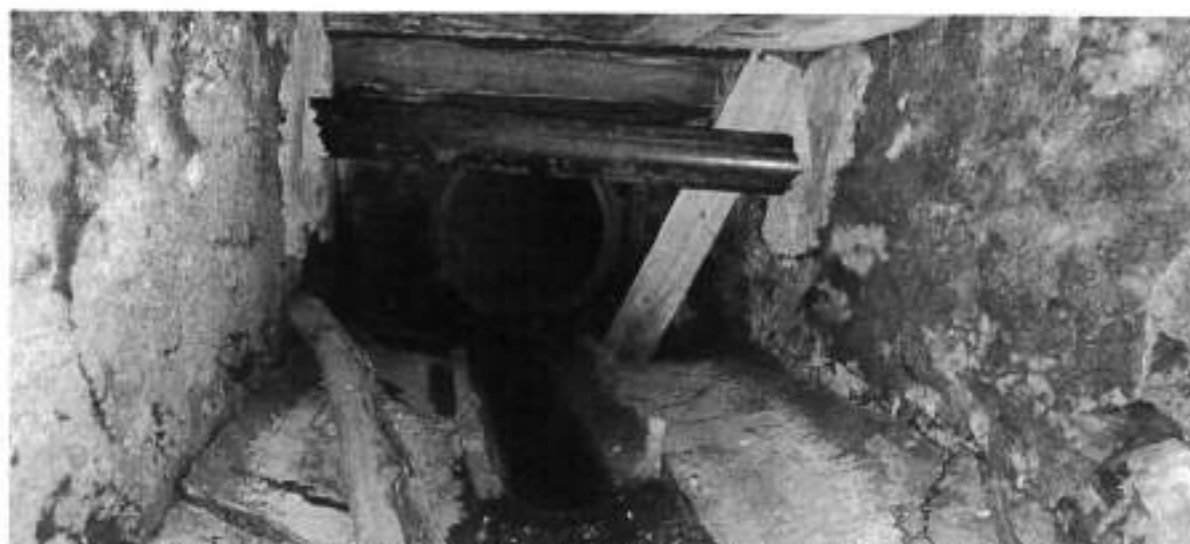
Figura 3 – Vista della condotta presente all'interno della tubazione del riale
