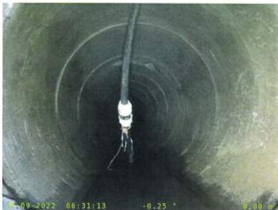
Figura 2 – Vista della condotta in PE presente all'interno della tubazione del riale
