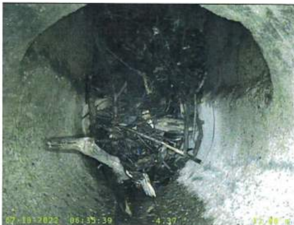
Figura 12 – Intasamento riscontrato alla progressiva +250, in corrispondenza della camera P2.1.
