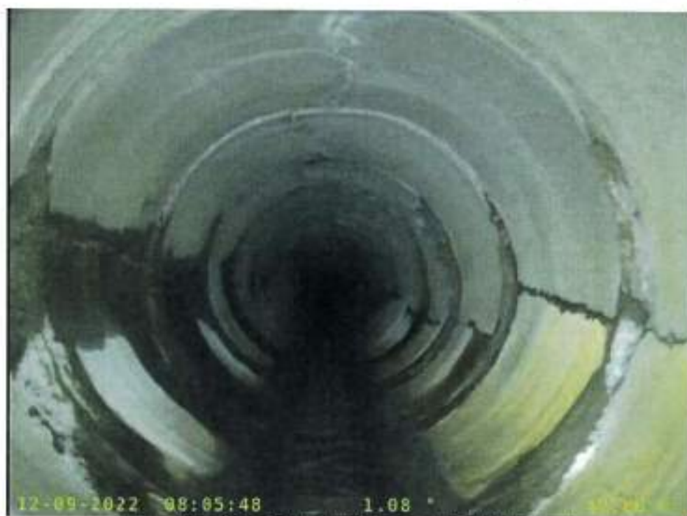
Figura 15 – Vista dello stato fessurato delle tubazioni.
